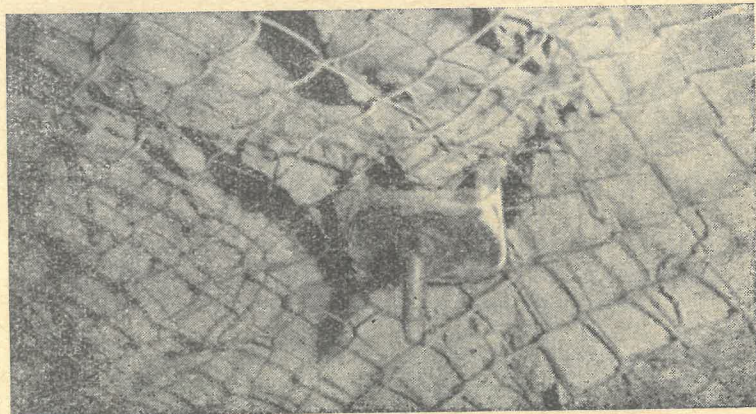
Obr. 14. Detail uchycení drátěného pletiva svorníkem.
