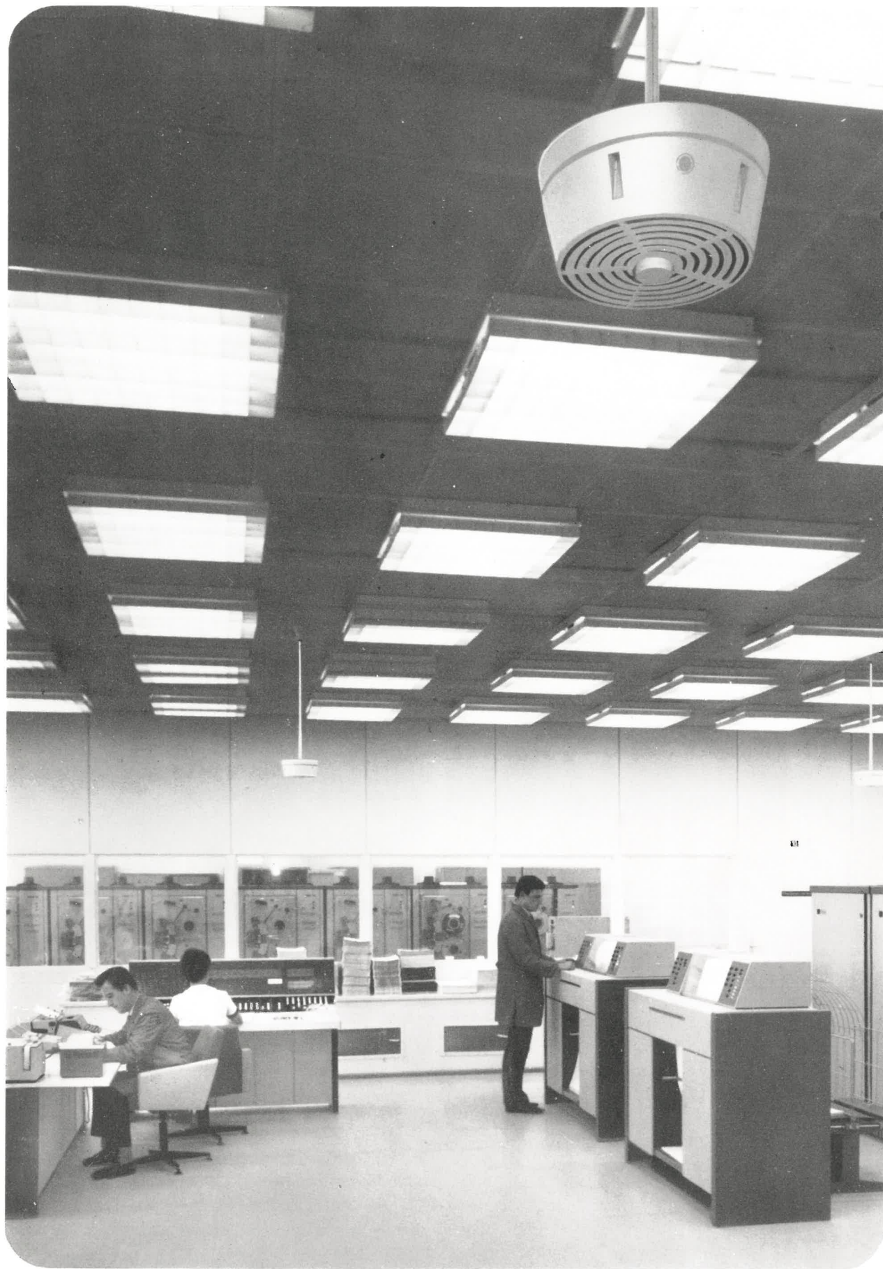
Ionisationsmelder in einem Forschungsinstitut
